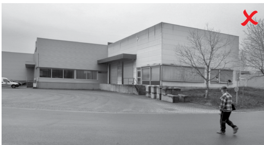
De onderhoudsstaat van deze gebouwen is onvoldoende
