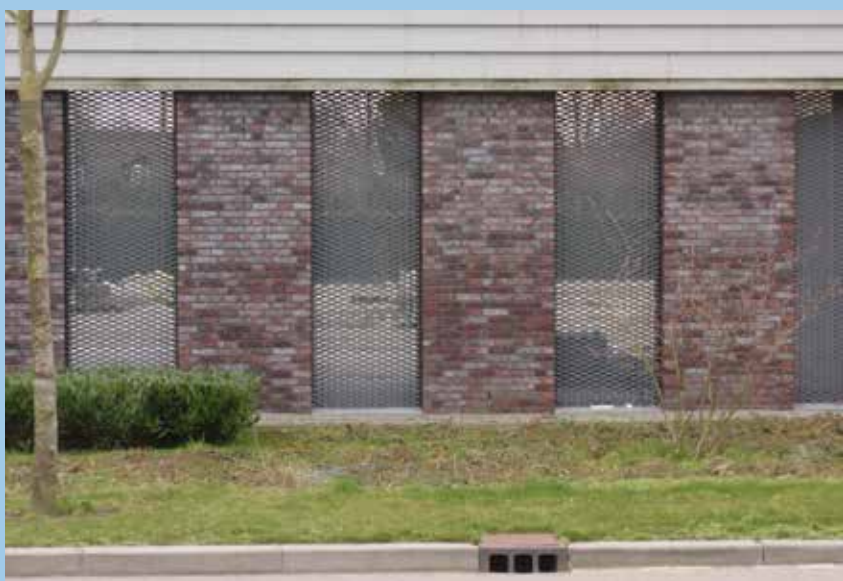
Op het bedrijventerrein Doornhoek te Veghel (NL) is deze afscherming van metselwerk en geperforeerde platen toegepast om de opslag van materialen op het terrein van dit bedrijf te camoufleren. De foto rechts toont een zijaanzicht. (Deze foto kon genomen worden omdat het aangrenzende perceel nog niet was bebouwd).
