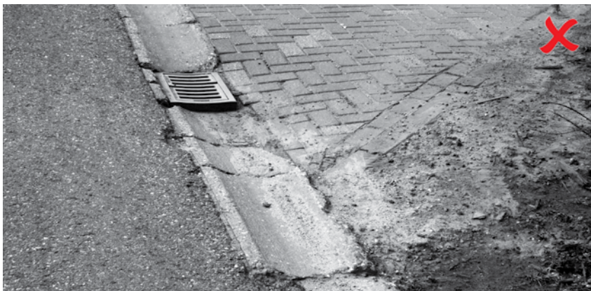
Slecht onderhoud van de openbare ruimte
